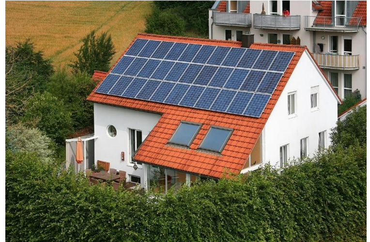
Photovoltaik Anlage auf Einfamilienhaus
