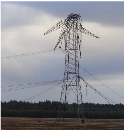
Sturmschaden durch den Orkan Kyrill im Jahr 2007
